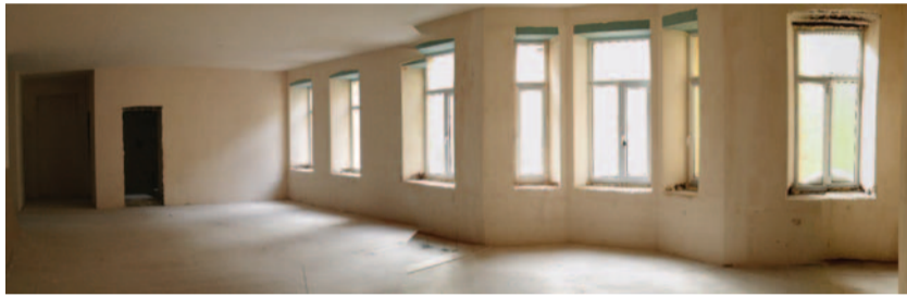
На фото: Внутренние помещения института на Лахтинской, подготовленные к отделочным работам. Вверху слева: Ведутся работы во внутреннем дворе института.
